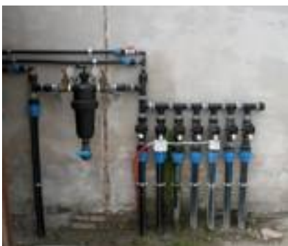
Collettore a 7 elettrovalvole in fibra di vetro installate fuori terra.
