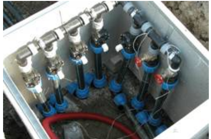
Collettore di alimentazione a 5 elettrovalvole alloggiato in un pozzetto interrato.
