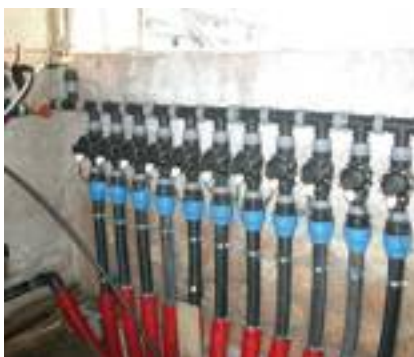
Gruppo di 11 elettrovalvole alloggiato in un locale centralizzato.
