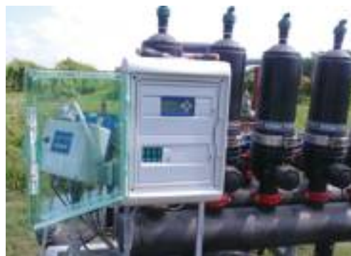
Elettroprogrammatore per il comando delle elettrovalvole alimentato dalla batteria a corrente continua. In secondo piano la centralina per il controlavaggio dei filtri automatici.
